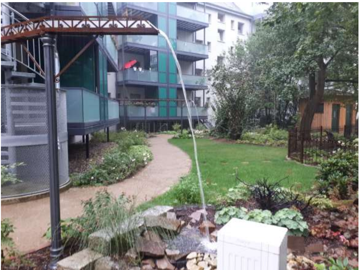
Bild 1-5: Zuleitung Niederschlagswasser von Dach im Osten zum Teich im Innenhof. Bildquellen: ISAH
