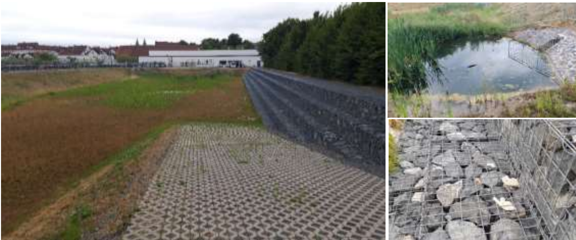
Abbildung 3-2: Regenrückhaltebecken Ostend; links: Übersicht; rechts oben: Schlammfang mit Algen; rechts unten: Essensreste in Gabionenwand
